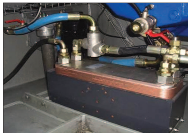
Bild 4 : Wärmetauscher nach Modifikation
