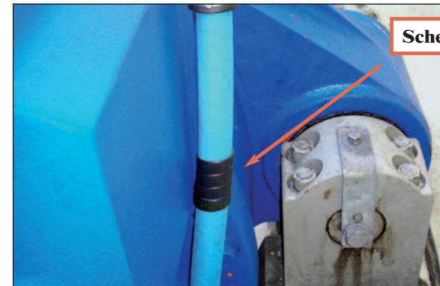
Bild 7 : Schlauchleitungen vor Modifikation
