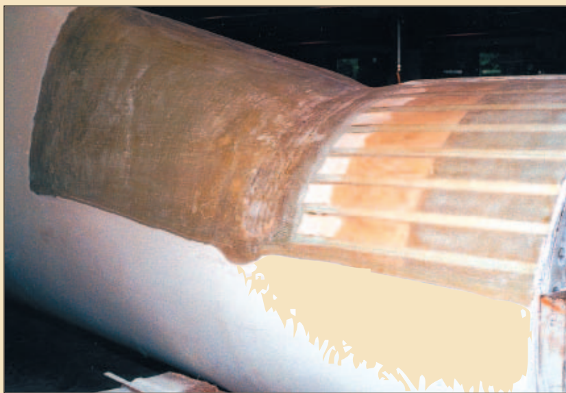
Reparatur von Querrissen an der Blattwurzel
