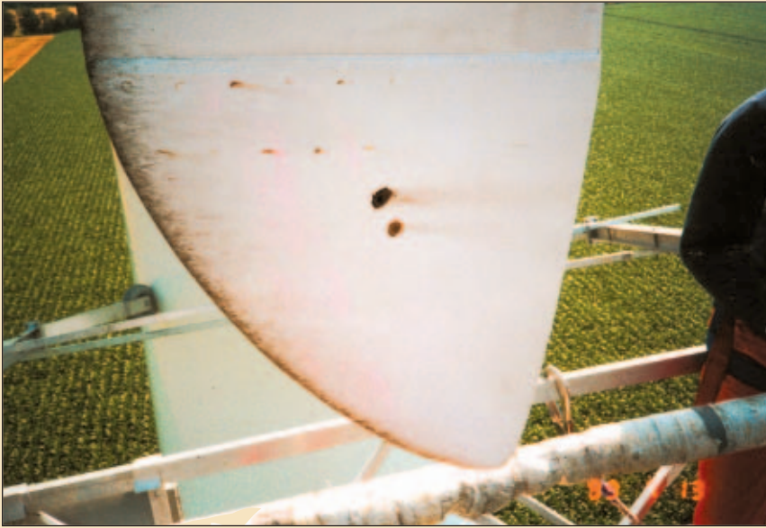
Blitzeinschläge in die Blitzschutzkappe
